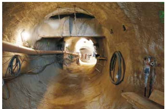
Abb. 2: Der Stollen mit den Abmessungen b \times h = 3,00 \times 3,30 m in gekrümmter Linienführung. Eine kreuzende Abwasserleitung wurde während der Baumaßnahme temporär abgefangen und später an den fertigen Kanal angeschlossen. (Foto: Güteschutz Kanalbau)
