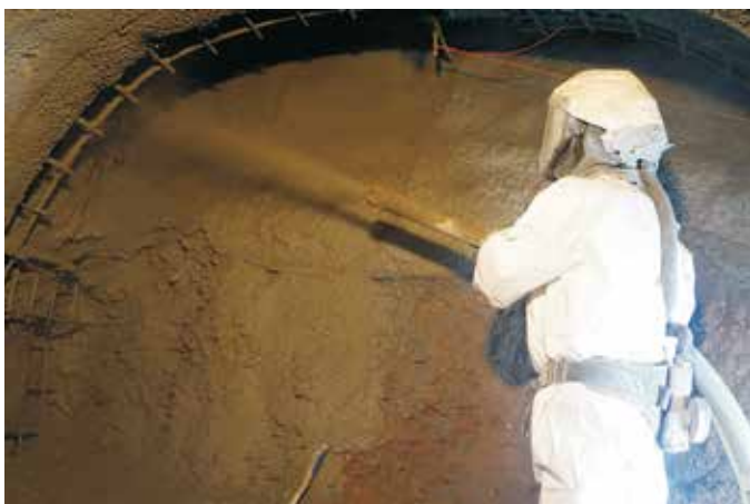
Abb. 3: Das Auftragen des Spritzbetons erfolgt direkt an der Ortsbrust zur Sicherung des Stollens. (Foto: Güteschutz Kanalbau)
