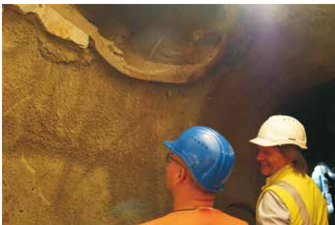
Abb. 1: Überreste der alten Trinkwasserleitung: Hier wäre jedes andere grabenlose Verfahren als der bergmännische Stollenvortrieb gescheitert. (Foto: Güteschutz Kanalbau)
